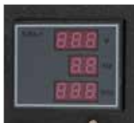
Display (tensão, frequência e contador de horas)
