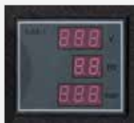
Display (tensão, frequência e contador de horas)
