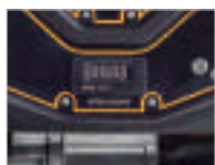
Display (tensão, frequência e contador de horas)
